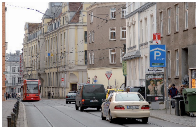
In der Wismarschen Straße, Ecke Arsenalstraße, werden die Gleise und die Weiche der Straßenbahn durch den Nahverkehr erneuert Foto: max
