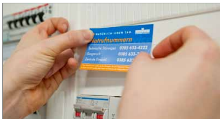
Gut sichtbar am Sicherungskasten angebracht, hat man die wichtigsten Rufnummern im Notfall sofort parat Foto: maxpress/jk
