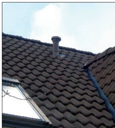
Mit einer Dachentlüftung werden Gerüche und Gase abgeführt Foto: SAE
