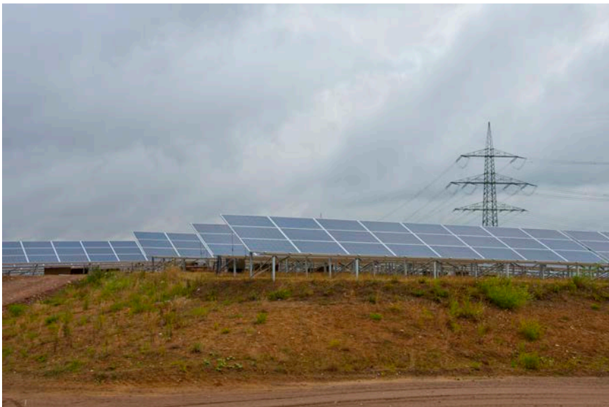
Bild: Ausschnitt der PV-Anlage aus süd-westlicher Richtung
