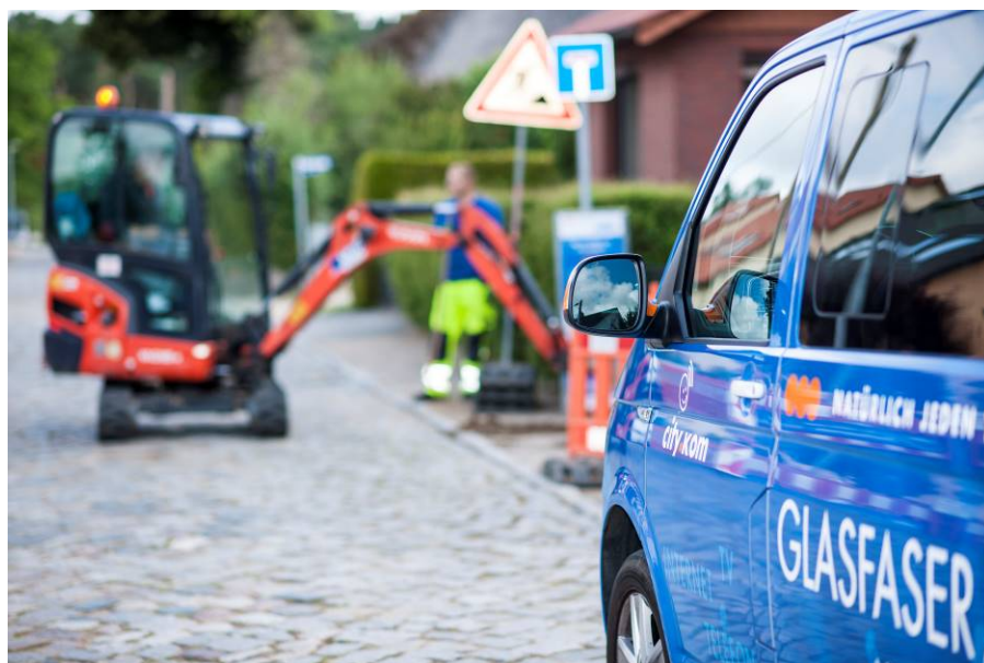
BU: Die Stadtwerke Schwerin erhöhten in diesem Jahr nochmals das Ausbautempo in ihrem city.kom-Glasfasernetz und öffentlichen city.WLAN. Fotos: Stadtwerke Schwerin
