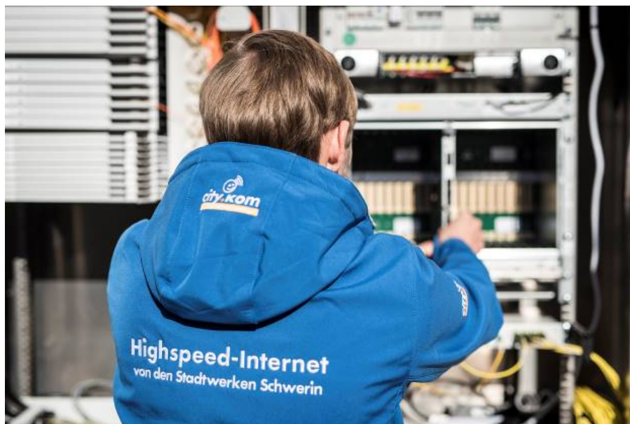
BU: Ein Stadtwerke-Servicetechniker nimmt einen neuen Glasfaseranschluss in Betrieb. Fotos: Stadtwerke Schwerin
