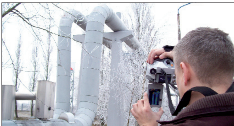
Mit einer Wärmebildkamera lassen sich Schwachstellen an den Schweriner Fernwärmeleitungen aufzeigen Fotos: SWS
