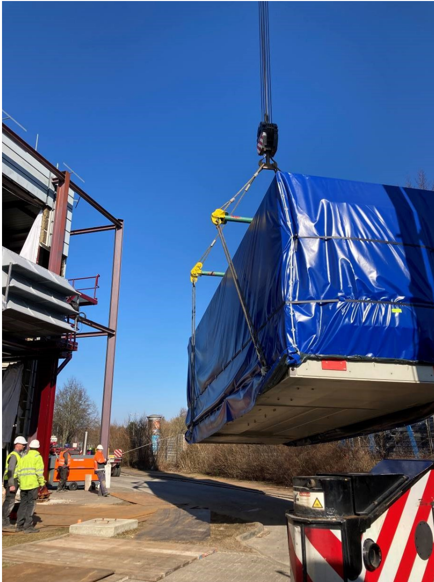
BU: Das 70 Tonnen schwere Package mit der darin verbauten Gasturbine schwebt am Kran. Foto: SWS
