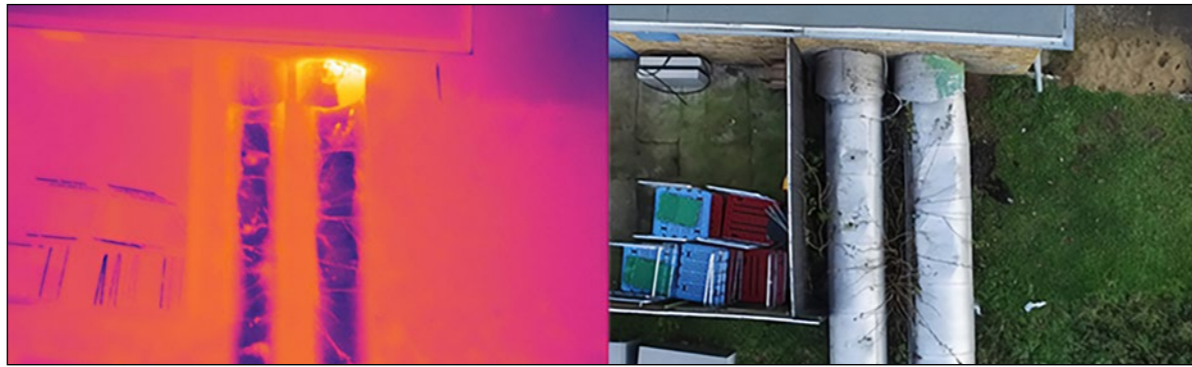
Auf dem linken Thermografiebild sind Wärmequellen gut erkennbar, rechts ist derselbe Leitungsabschnitt in Normalaufnahme zu sehen
