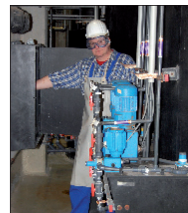
Schichtleiter Jürgen Sevecke im Bereich der chemischen Wasseraufbereitung
